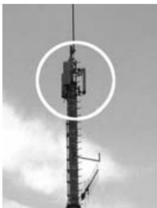
TETRA-Antenne (ähnelt stark Mobiltelefon-Antennen; charakteristisch sind drei Strahler)
